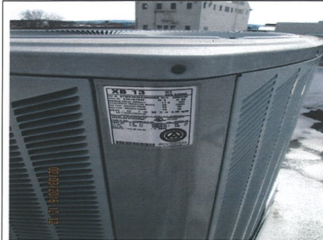
Item 39A condenser label.
